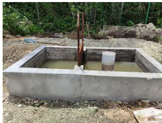
Figura 13 Pozo de infiltración de agua tratada
