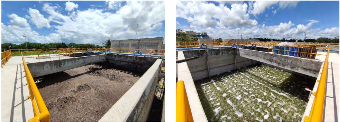
Figura 13 Celda 3 del digestor de lodos, celda 1 del digestor de lodos
