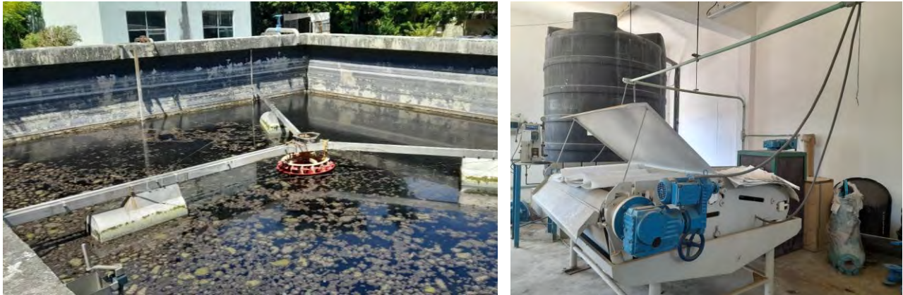
Figura 7 Digestor aerobio de Lodos y Filtro banda
