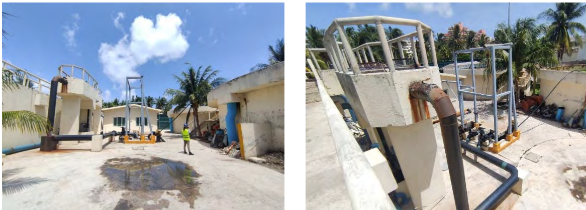
Figura 6 Vista general Pretratamiento y Cárcamo de Bombeo 1ª Etapa
