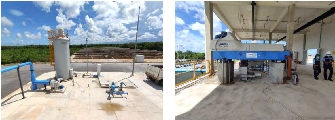
Figura 14 Sistema Control de Olor y Centrífuga de Desaguado de Lodos
