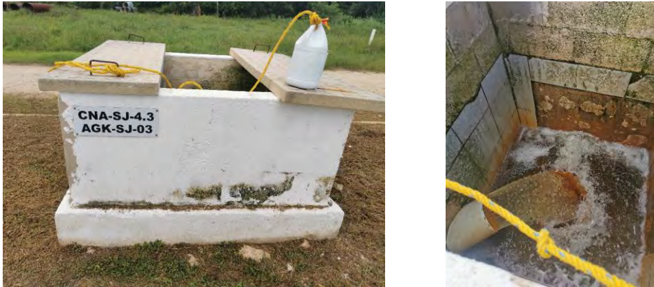
Figura 9 Pozo de Infiltración y Agua Tratada
