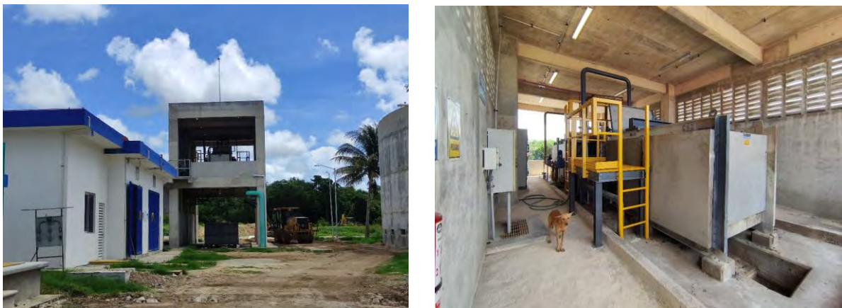
Figura 14 Caseta de desaguado de lodo digerido; filtros banda para desaguado de lodo
