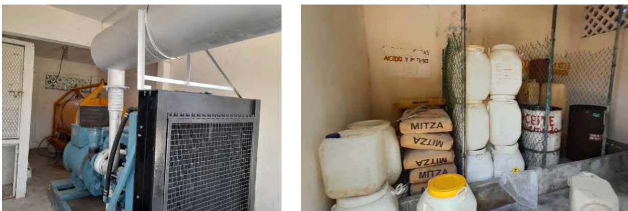
Figura 6 Planta de emergencia y almacén de químicos
