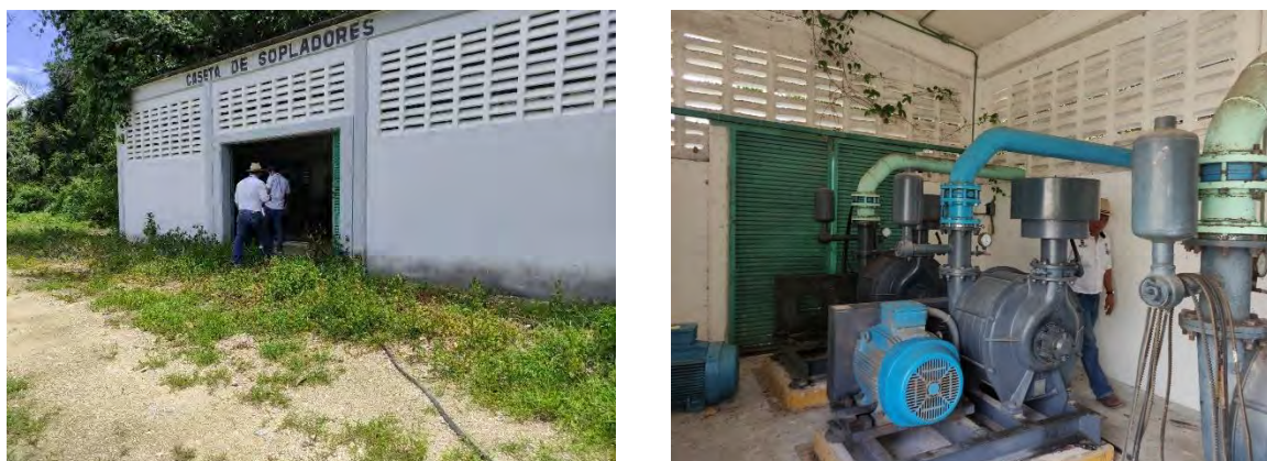
Figura 19 Caseta de sopladores para proceso de agua y de digestión de lodos.
