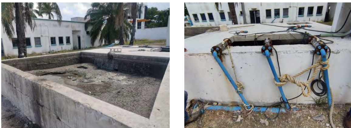
Figura 3 Estación de recepción de aguas de pipas con agua residuales y residuos de fosas sépticas.
