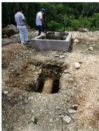
Figura 12 Estación de desinfección ultravioleta con deterioro severo, estructura de lámparas UV abandonadas
