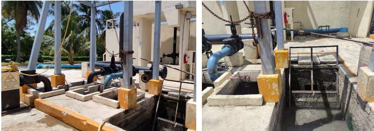
Figura 5 Cárcamo de Bombeo de Agua Cruda y Cribas de Pozo de Gruesos 1ª Etapa
