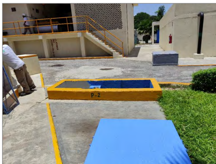
Figura 23 Pozos de infiltración PTAR El Rey
