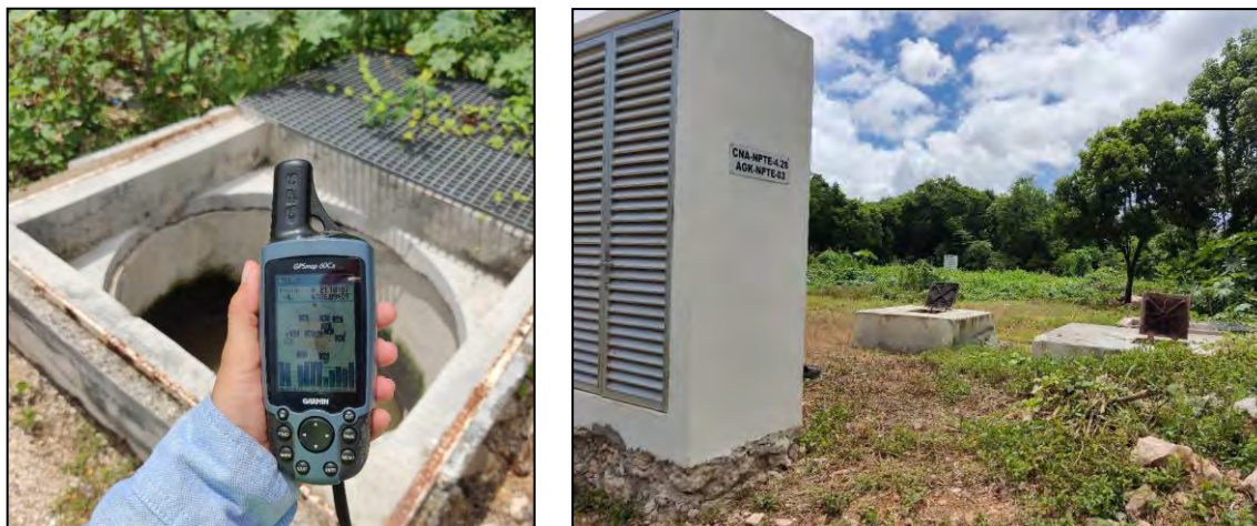
Figura 20 Pozos de infiltración PTAR Norponiente I
