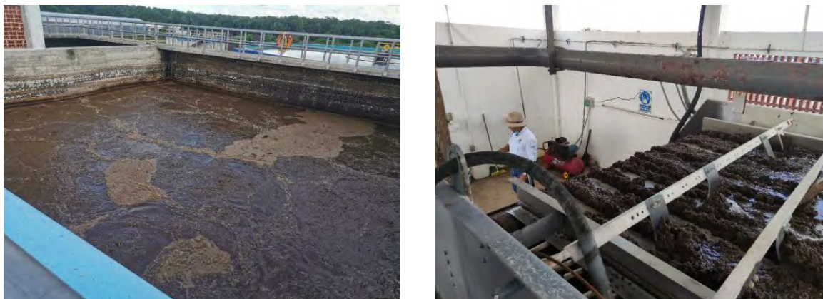
Figura 10 Digestor Aerobio de Lodos y Filtro Banda en Operación
