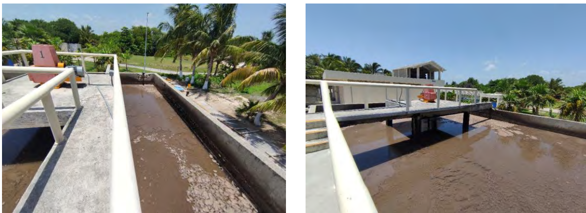
Figura 14 Digestor aerobio de lodos
