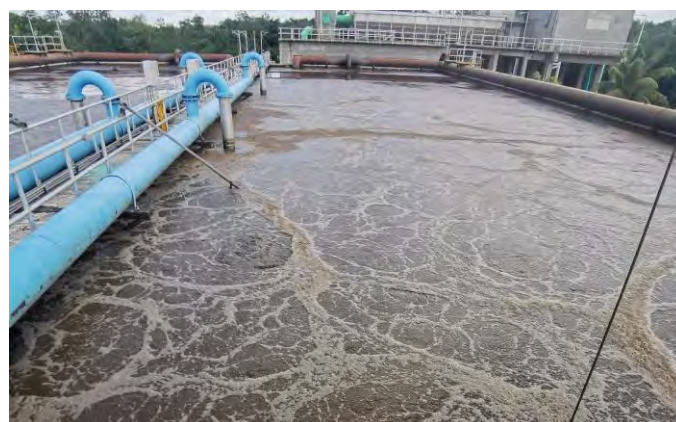
Figura 5 Reactor de Lodos Activados
