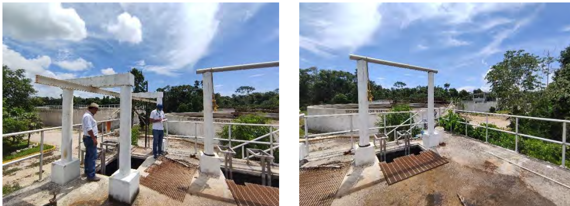
Figura 14 Cárcamo de recirculación de lodos secundarios
