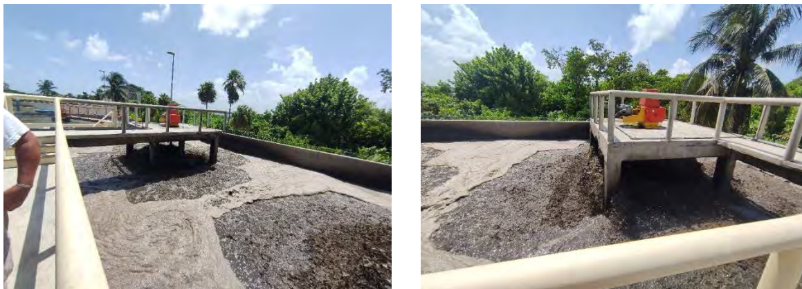
Figura 23 Digestor Aerobio de Lodos 1ª Etapa
