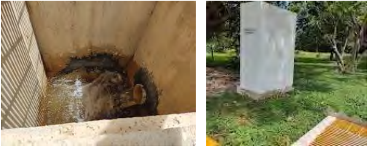
Figura 19 Pozos de infiltración PTAR Norte
