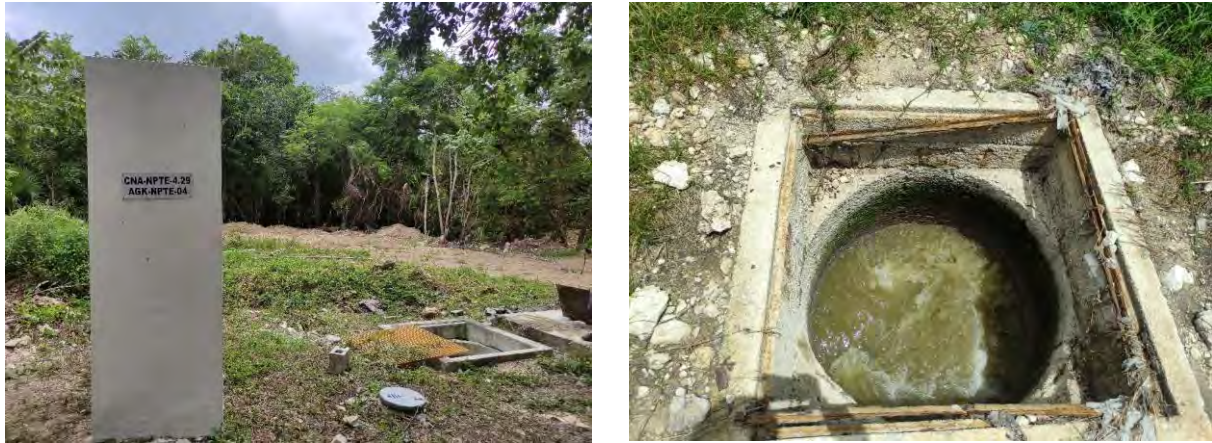
Figura 11 Pozos de infiltración de agua tratada
