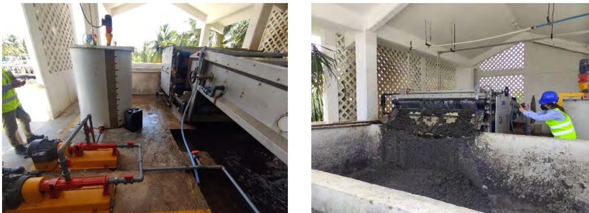
Figura 24 Preparador de Polímero y Filtros Banda 1ª Etapa
