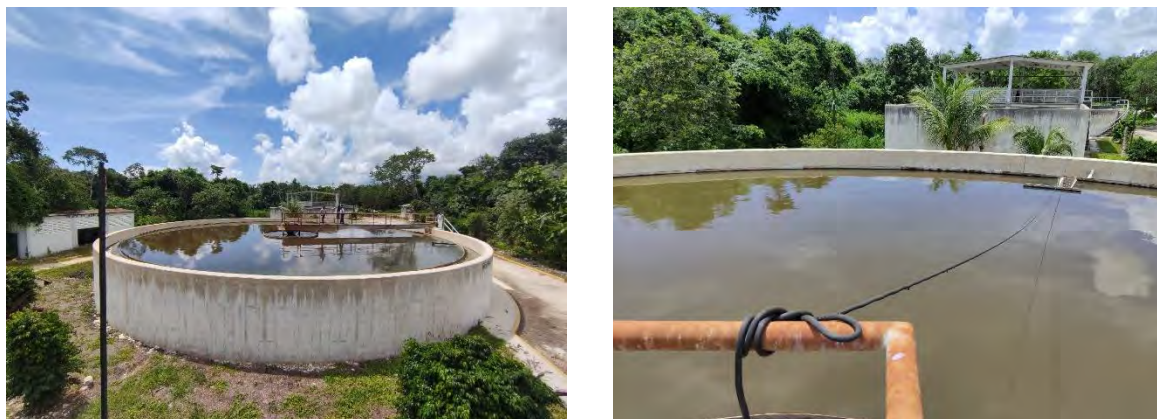
Figura 10 Clarificación secundaria de puente fijo, cableado eléctrico inadecuado
