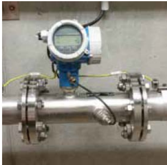
Figura 32. Ejemplo de medidor de caudal. (Programa Aprovechamiento Energético de Residuos Urbanos en México, 2017).
