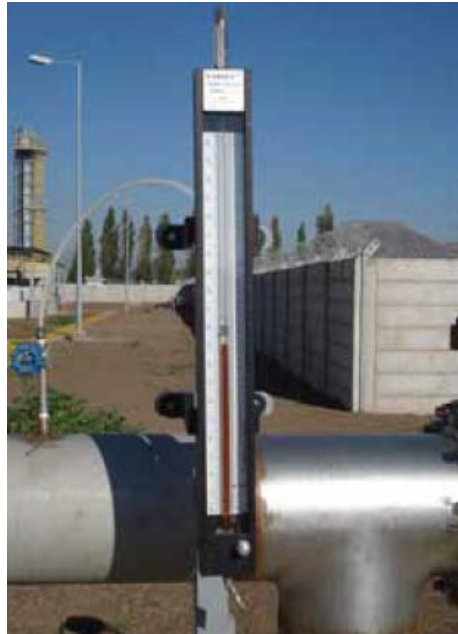
Figura 31 Ejemplo de manómetro para la medición de presión. (Programa Aprovechamiento Energético de Residuos Urbanos en México, 2017).
