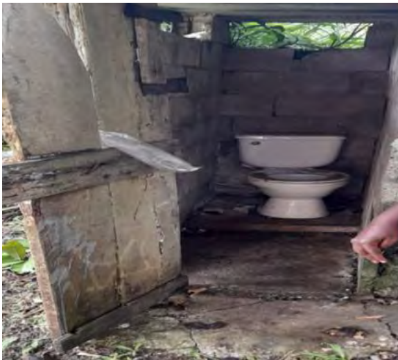
Figure 5: Pour flush latrine (Source:Jodian/Org./2022).
