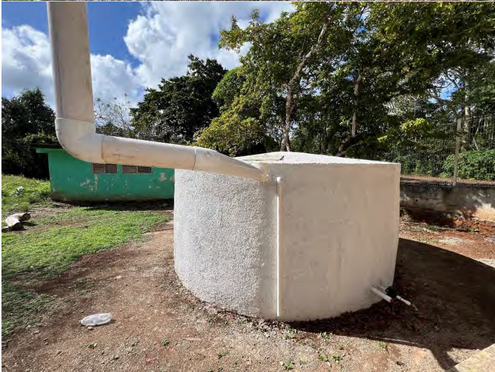
Figuras 129 y 130. SCALL y Cisterna entregados en la comunidad de Yodzonot Nuevo.
