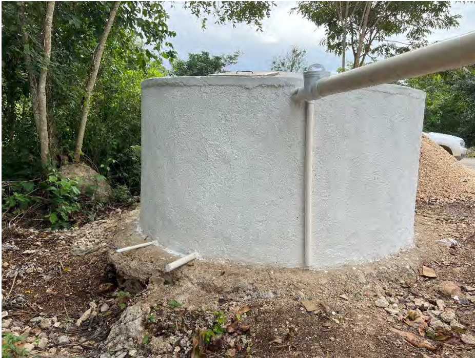
Figura 117. SCALL y cisterna del área de sanitarios.
