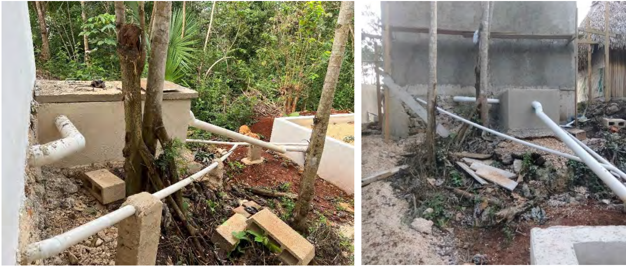
Figuras 51 y 52. Contenedor de sólidos de dos cámaras.
