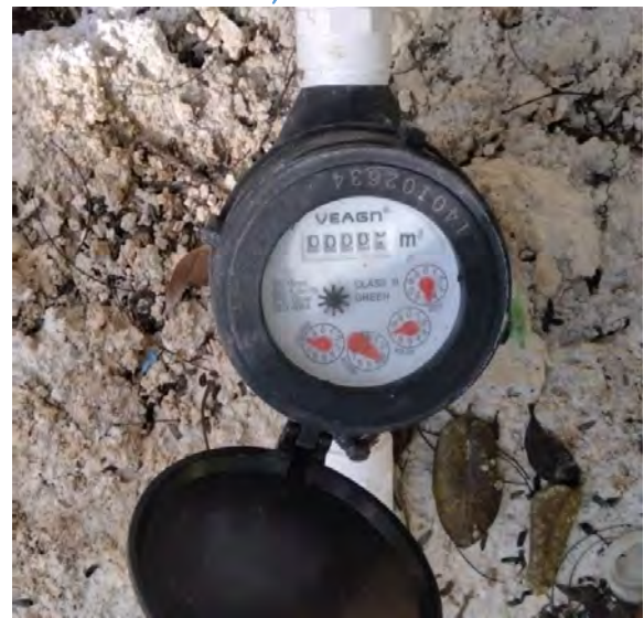
Cisterna de los Sanitarios 1,490 litros
