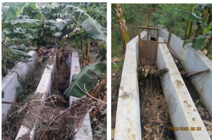
Estado de abandono del desarenador de la planta de tratamiento
