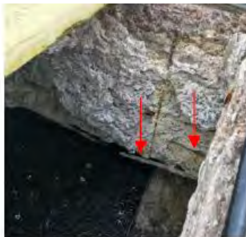
Afectación de hormigón no revestido en reactores UASB operativos (Chernicharo y Bressani, 2019)
