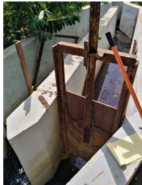
Ausencia de compuertas y rejillas en desarenador actual
