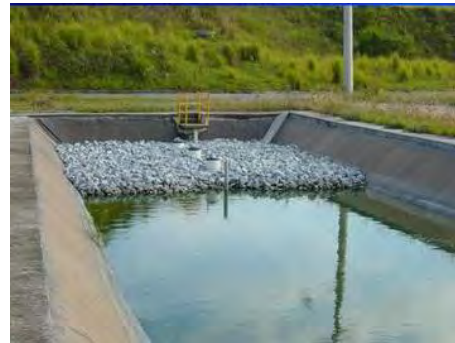
Filtro de piedra para pulimiento de efluentes lagunares (Andrada, 2005).
