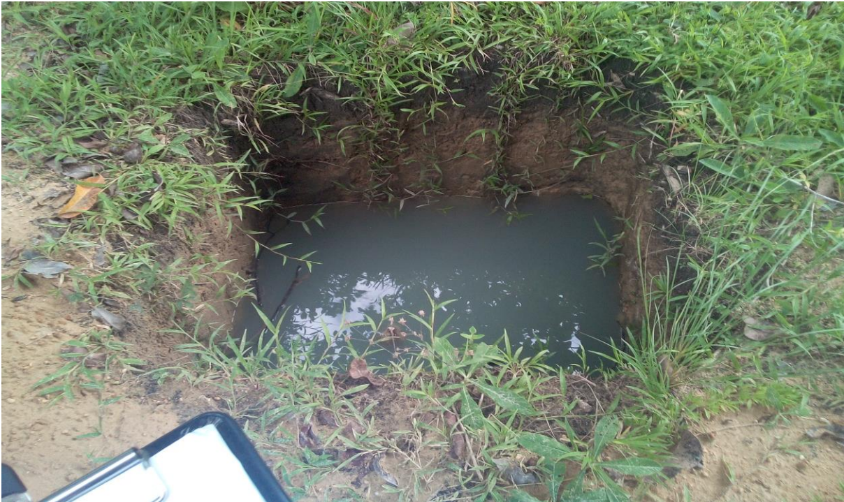
FOTO NO. 3: Vista de una fosa de letrina para futura construcción por sus propios medios.
