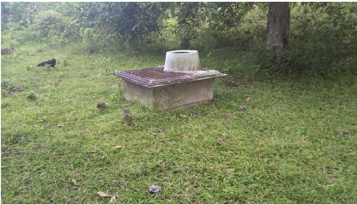
FOTO No. 2: Vista de fosa de una letrina de material de fibra de vidrio, en buen estado.
